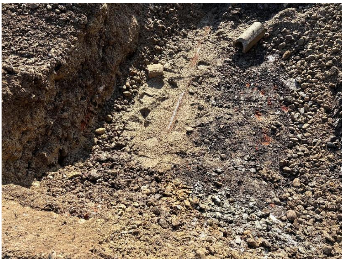
Foto 18: Angetrof enes Kabelrohr (SB-2)
