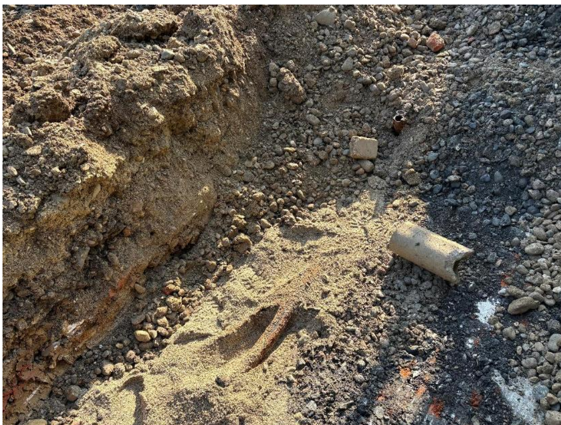
Foto 17: Angetrof enes Kabelrohr (SB-2)
