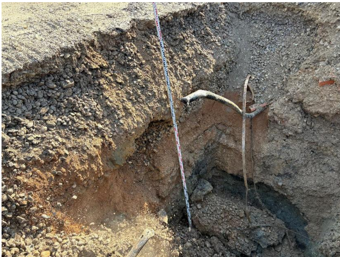
Foto 19: Angetroffene Leitungen (SB-2)
