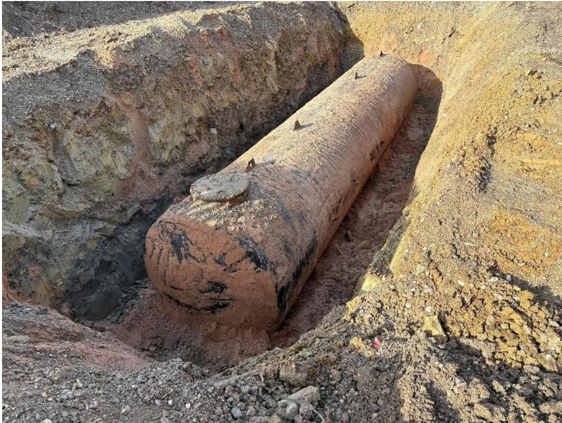
Foto 23: Freigelegter 30 000 l Dieseltank
