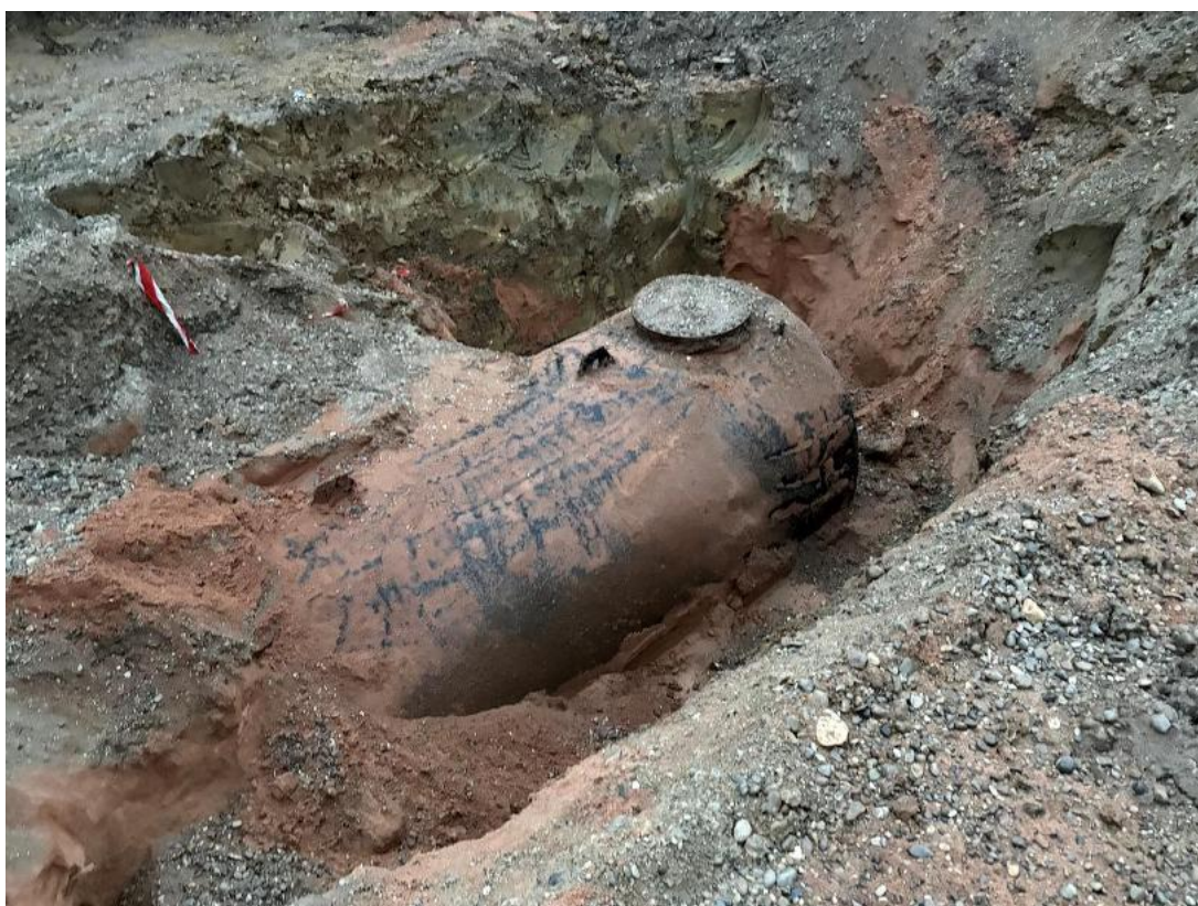
Foto 22: Freigelegter 30 000 l Dieseltank
