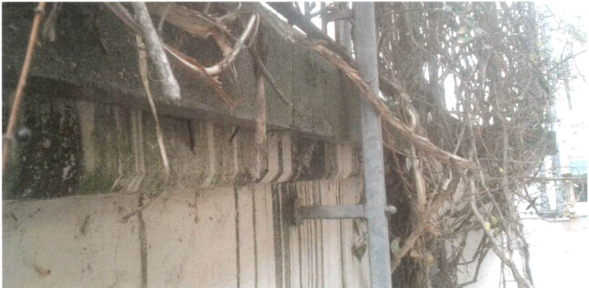
Abb. 6: Gehweg mit Überstand. Wasserschlieren deuten auf die mangelnde Entwässerung des oberseitigen Gehwegs.
