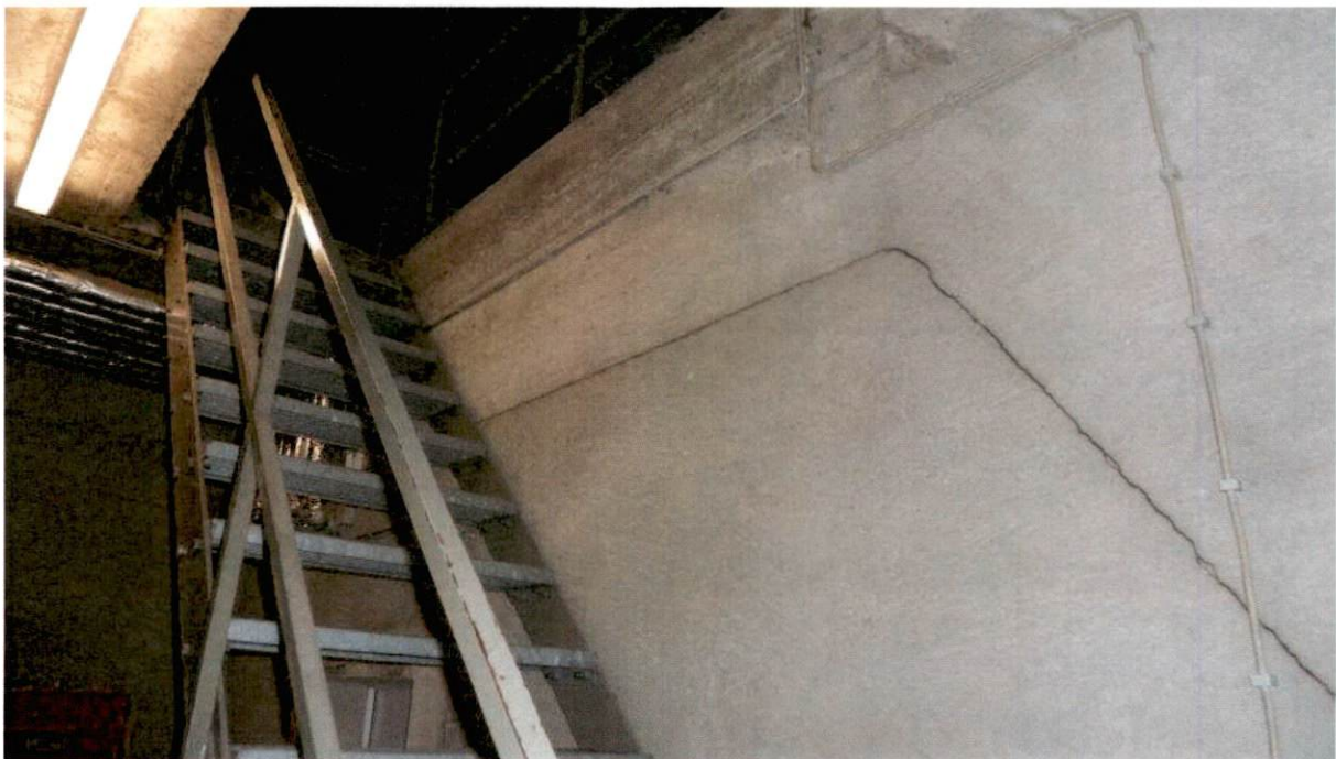
Abb. 14: Rissverlauf unterhalb Stahlbetonrahmen im Dachgeschoss
