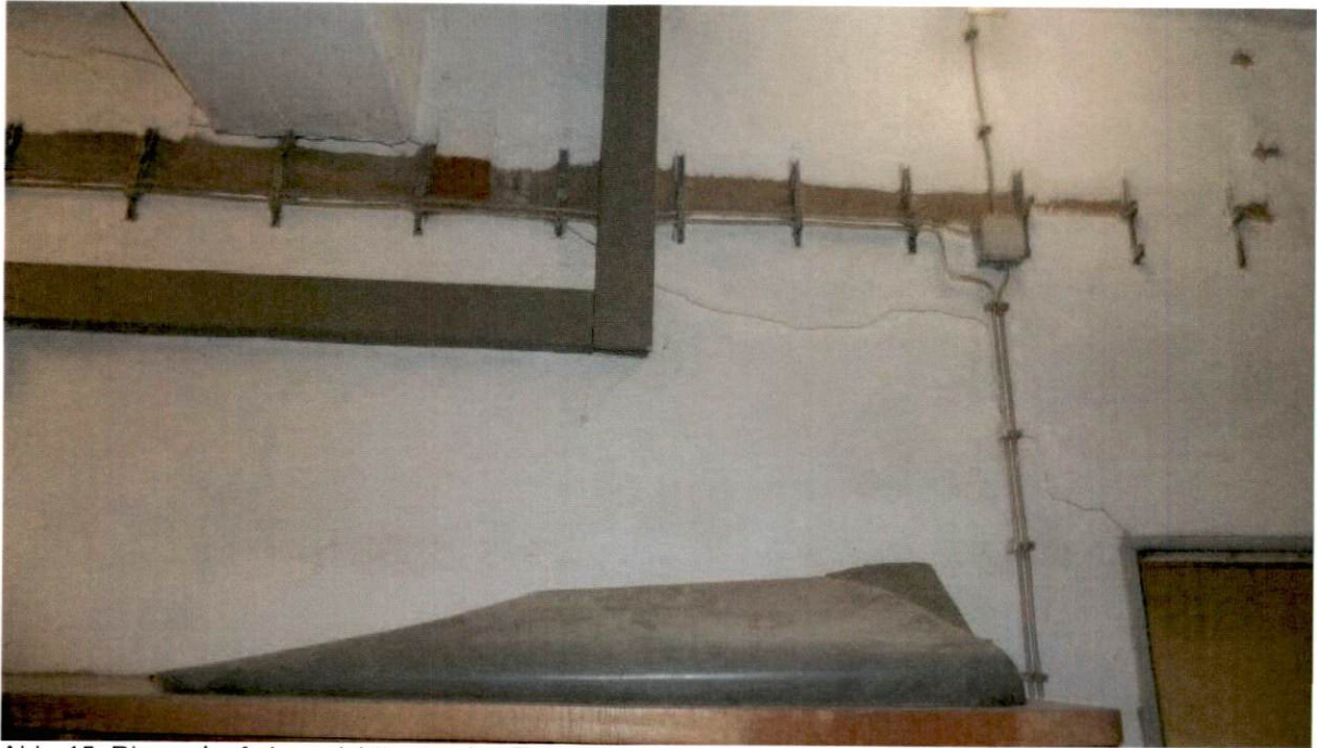
Abb. 15: Rissverlauf einer nichttragenden Trennwand senkrecht zum Stahlbetonrahmen
