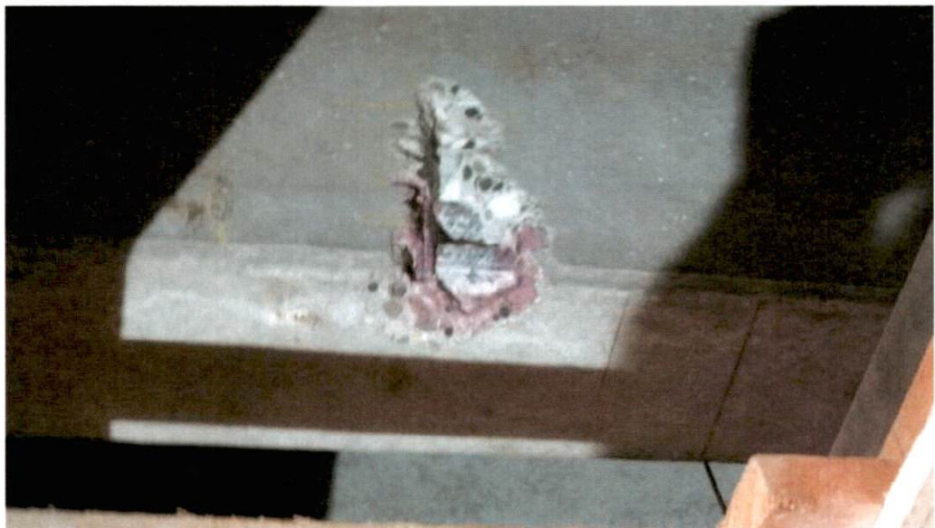
Abb. 2: Freigelegte Bewehrung einer Stahlbetonrippe
