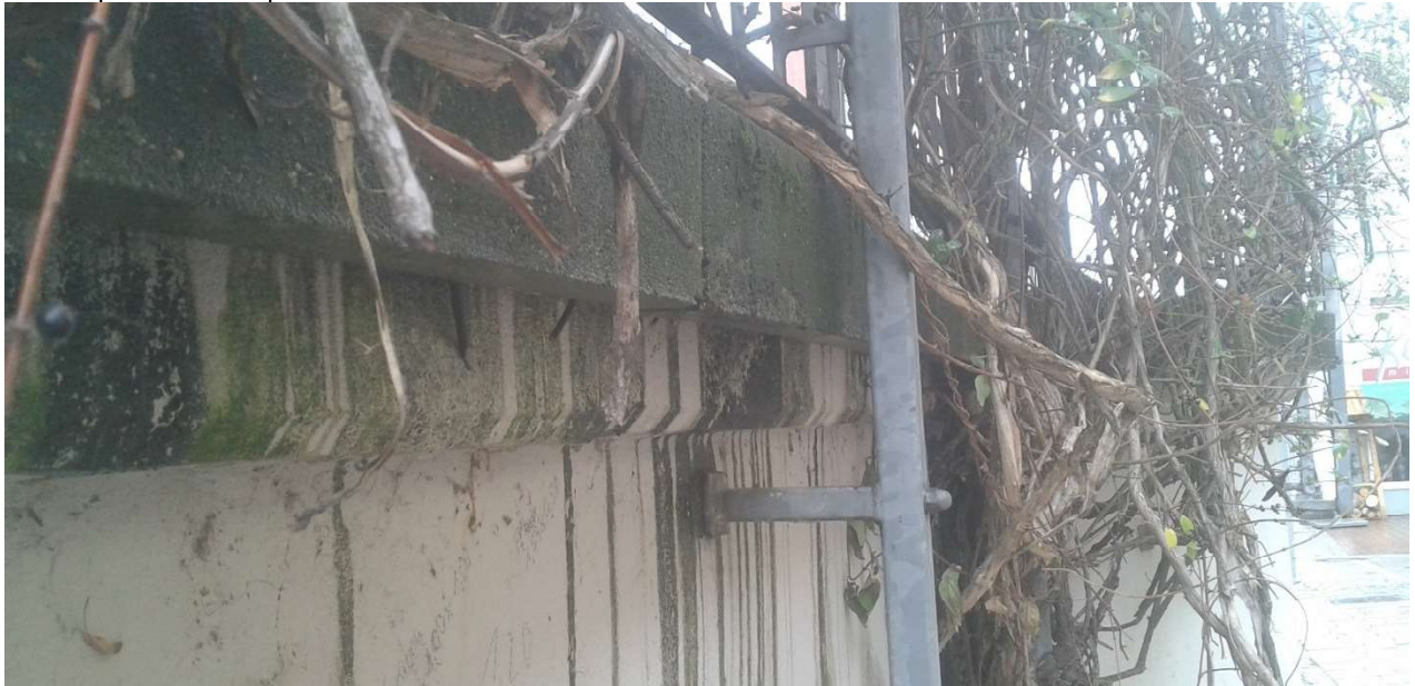
Abbildung: Gehweg mit Überstand. Wasserschlieren deuten auf die mangelnde Entwässerung des oberseitigen Gehwegs.
