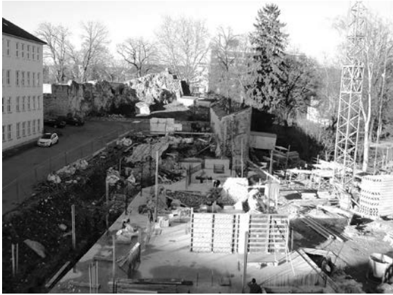
Neubau Forum für Bildung und Energie
